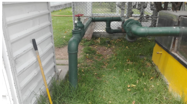
Foto No. 3 Estructura hidráulica externa del pozo pz-09-0040
